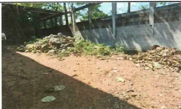
Foto 3: En esta foto se puede ver que hay necesidad de piso.
